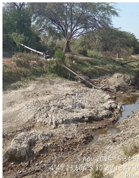
Imagen n.° 13 Presencia de colmatación y maleza en canal Miguel Checa
