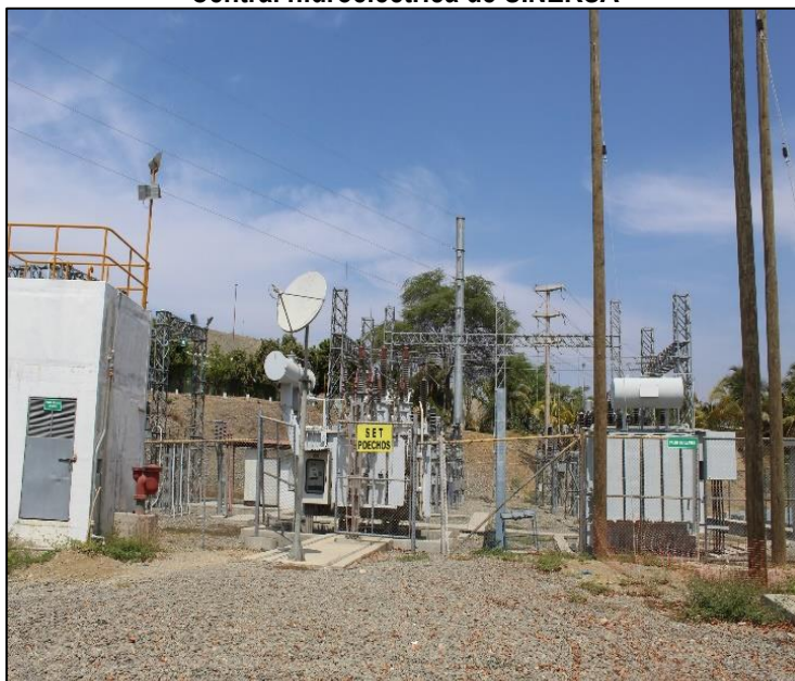
Imagen n.º 10 Central hidroeléctrica de SINERSA
