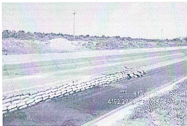
Losas colapsadas en Canal Daniel Escobar – Progresiva 31+500
