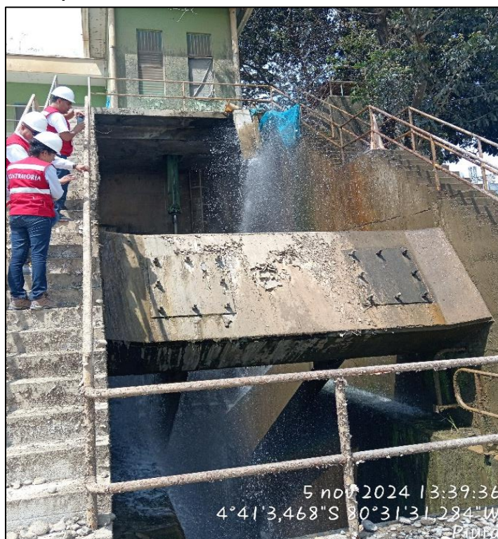
Imagen n.º 11 Compuerta en mal estado, no cierra herméticamente
