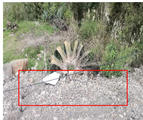
Fuente: Acta de inspección física de obra n.° 002-2024-MDSM/OCI-SCC-TRANSITABILIDAD
