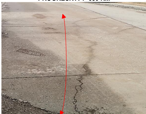
FOTOGRAFÍA N° 31 VISTA DONDE SE OBSERVA FISURA LONGITUDINAL EN EL PAVIMENTO RÍGIDO PROGRESIVA 1+680 KM
