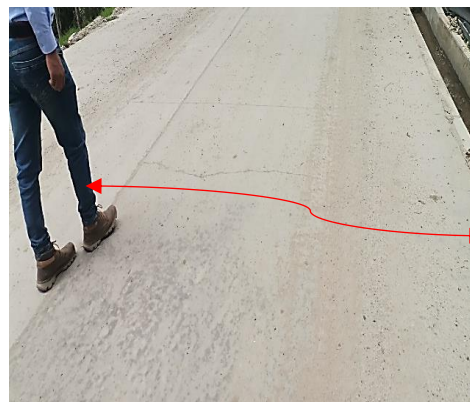
FOTOGRAFÍA N° 36 VISTA DONDE SE OBSERVA FISURA TRANSVERSAL EN PAVIMENTO RÍGIDO PROGRESIVA 1+900 KM
