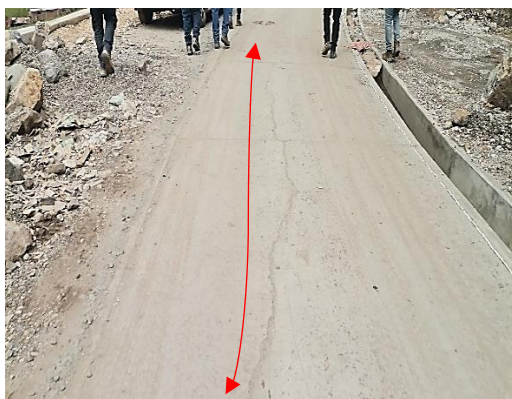
FOTOGRAFÍA N° 33 VISTA DONDE SE OBSERVA FISURA LONGITUDINAL EN EL PAVIMENTO RÍGIDO PROGRESIVA 1+740 KM
