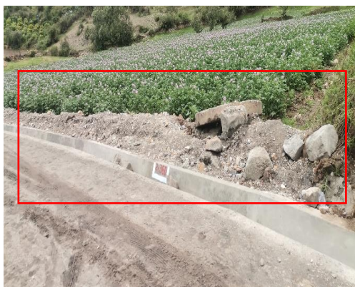
Fuente: Acta de inspección física de obra n.° 002-2024-MDSM/OCI-SCC-TRANSITABILIDAD
