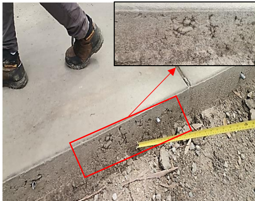
FOTOGRAFÍA N° 39 VISTA DONDE SE OBSERVA CANGREJERAS EN EL PAVIMENTO RÍGIDO PROGRESIVA 0+400 KM
