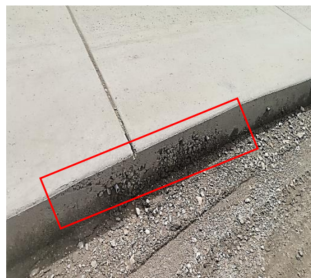
FOTOGRAFÍA N° 38 VISTA DONDE SE OBSERVA CANGREJERAS EN EL PAVIMENTO RÍGIDO PROGRESIVA 0+350 KM
