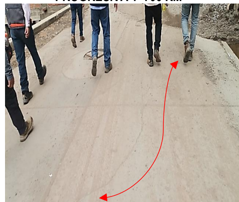
FOTOGRAFÍA N° 32 VISTA DONDE SE OBSERVA FISURA LONGITUDINAL EN EL PAVIMENTO RÍGIDO PROGRESIVA 1+700 KM
