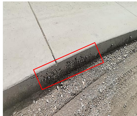
FOTOGRAFÍA N° 40 VISTA DONDE SE OBSERVA CANGREJERAS EN EL PAVIMENTO RÍGIDO PROGRESIVA 0+350 KM
