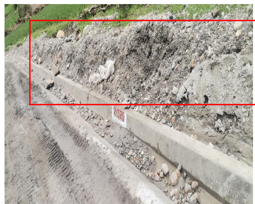
Fuente: Acta de inspección física de obra n.° 002-2024-MDSM/OCI-SCC-TRANSITABILIDAD
