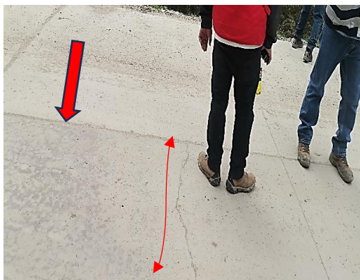
FOTOGRAFÍA N° 35 VISTA DONDE SE OBSERVA FISURA TRANSVERSAL EN PAVIMENTO RÍGIDO PROGRESIVA 1+900 KM
