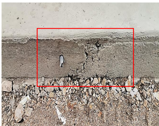
FOTOGRAFÍA N° 37 VISTA DONDE SE OBSERVA CANGREJERAS EN PAVIMENTO RÍGIDO PROGRESIVA 2+880 KM
