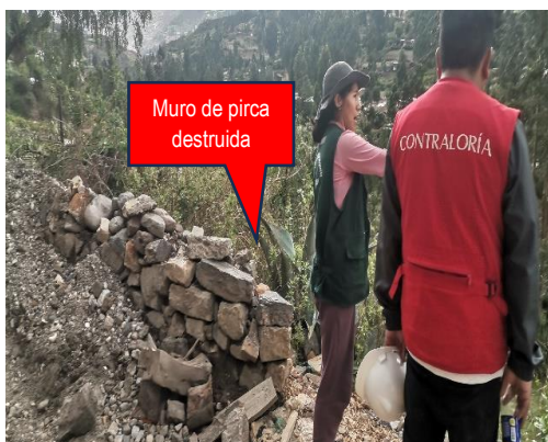
Fuente: Acta de inspección de obra n.º 002-2024-MDSM/OCI-SCC-TRANSITABILIDAD
