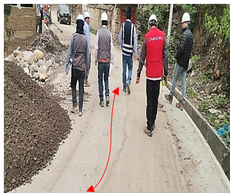
FOTOGRAFÍA N° 34 VISTA DONDE SE OBSERVA FISURA LONGITUDINAL EN EL PAVIMENTO RÍGIDO PROGRESIVA 1+840 KM
