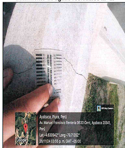
Imagen n.º 4 Fisuras halladas en las estructuras de la Planta de tratamiento de aguas residuales n.º 2.
