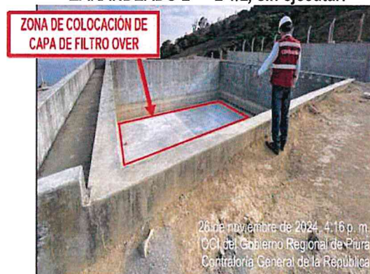
Imagen n.º 6 Partida 01.02.04.05.04 FILTRO DE OVER ZARANDEADO 2" - 2 1/2, sin ejecutar.
