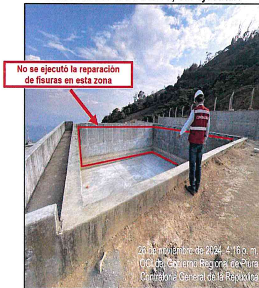
Imagen n.º 3 Partida 01.02.04.01.04 REPARACIÓN DE FISURAS EN TARRAJEO, sin ejecutar.
