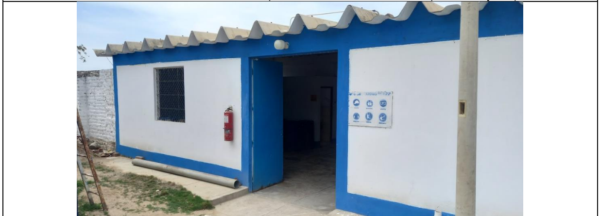
Extintores ubicados en el exterior de la sala de impulsión 1 se encuentran a la intemperie, sin caja de protección.
