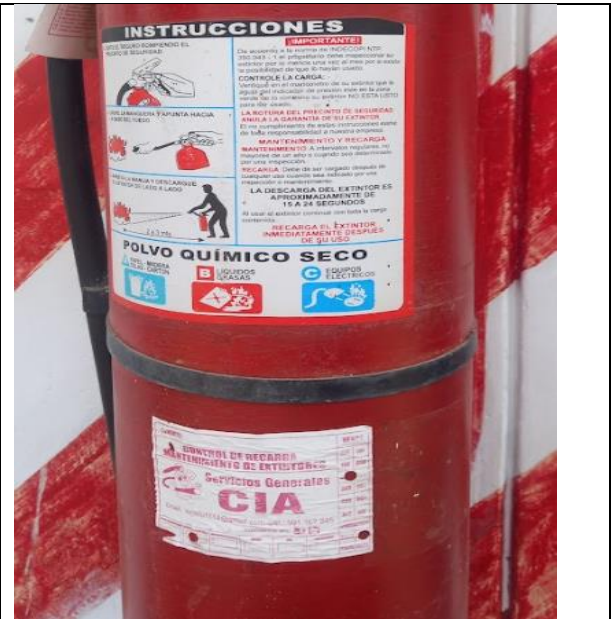
El extintor ubicado en el exterior del laboratorio se encuentra con la recarga vencida (junio-2020).
