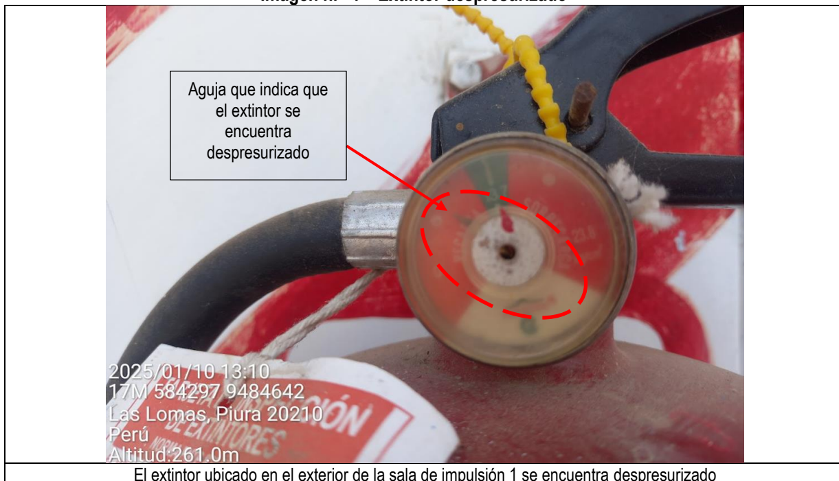
Imagen n.º 4 – Extintor despresurizado
