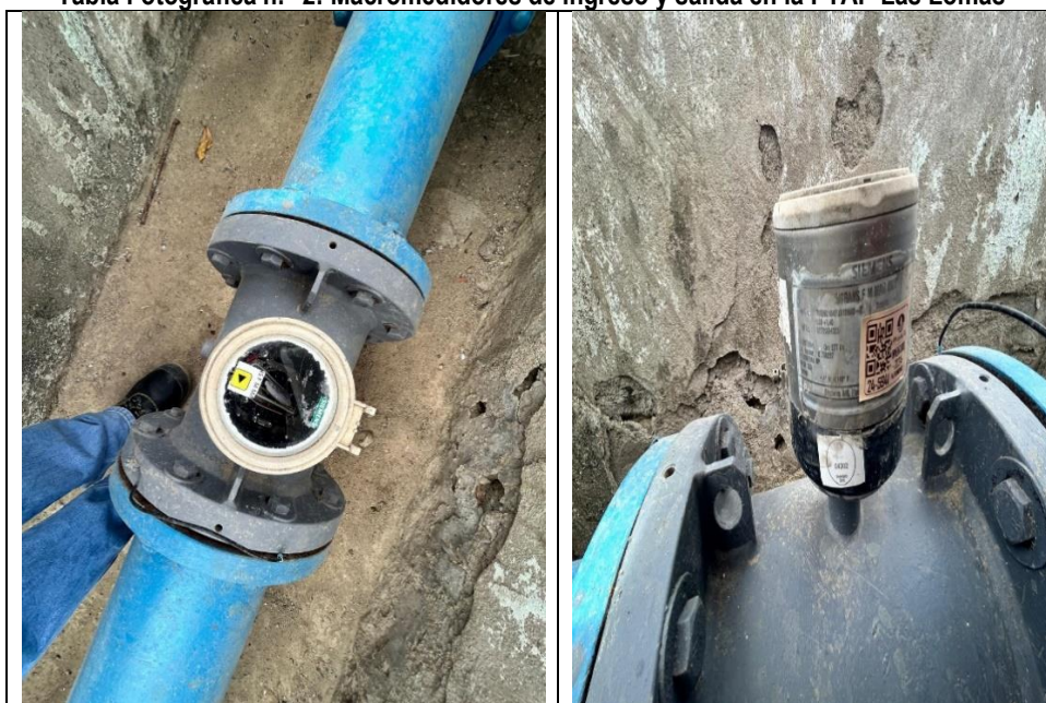
Macromedidor de salida PTAP Las Lomas- sin display.
